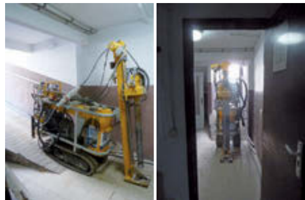
Figura 6. Acceso de equipo de preperforación al lado de actuación en el edificio existente. Circulación por pasillos y entrada a través de puertas.
