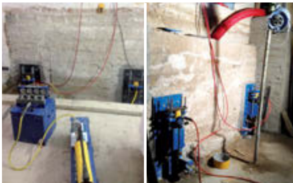
Figura 9. Puesta en carga simultánea de los cuatro aparatos de recalce 2PE. Se puede ver el lado del edificio existente (foto izquierda) con un distribuidor hidráulico de cuatro canales. En el lado de la ampliación, se pueden ver los manguitos hidráulicos pasando a través de una ventana existente.
