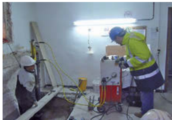
Figura 7. Hincas hidráulicas de perfiles en el lado del edificio existente. La hincas se realizó con una central de alto caudal alcanzando presiones superiores a 500 kg/cm 2 .
